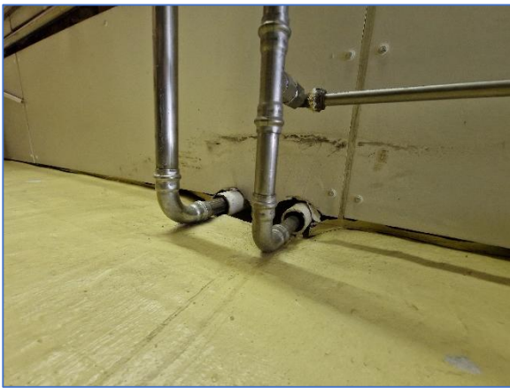
Foto 3: Gennemførelse af stigestreng
