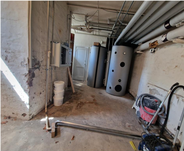
Foto 1: Varmecentral i sin helhed
