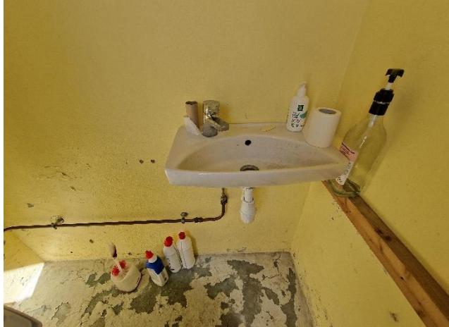
Foto 6: Sammenblandede rørmaterialer - gårdtoilet har kobberør
