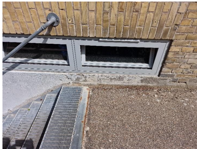
Foto 2: Ingen opkant ved kældernedgange
