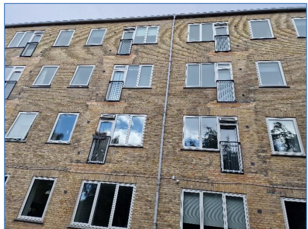
Foto 4: Murværk mod gård, partielt udbedret ved franske altanpartier
