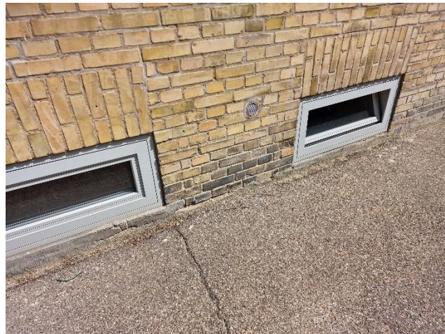
Foto 4: Kældervinduer placeret over terræn
