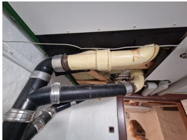
Foto 2: Faldstamme i kælder
