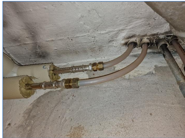
Foto 2: Fordelingsledninger i kælder
