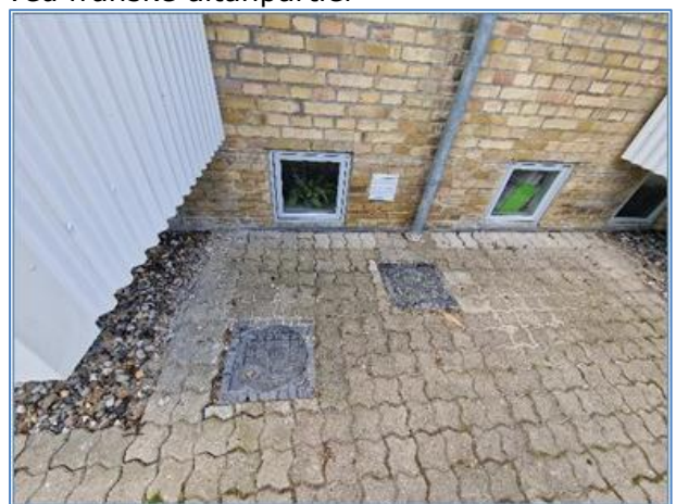
Foto 6: Tagnedløb og regn brønd
